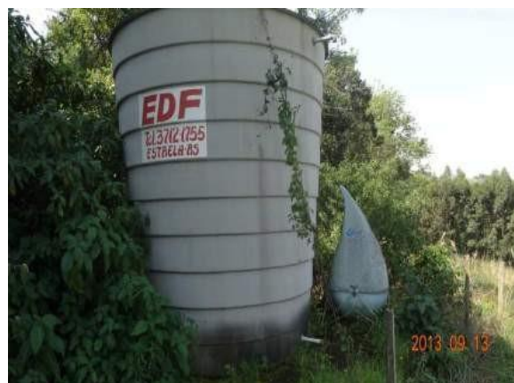
Figura 46: Reservatório da Linha Harmonia Alta.
