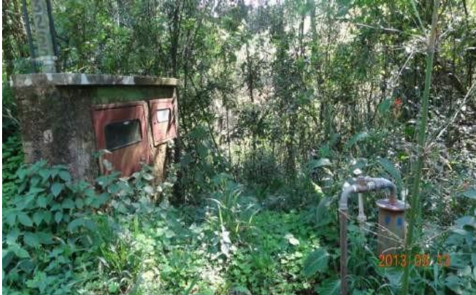
Figura 42: Poço da Linha Vale da Harmonia.
