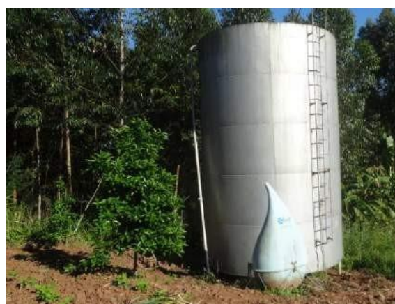
Figura 52: Reservatório de 45.000l da Linha Seca Baixa 01.
