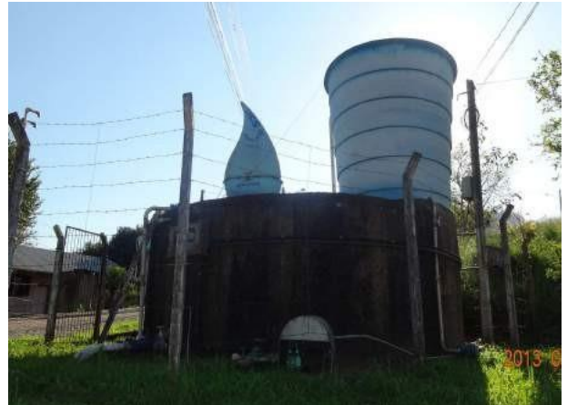
Figura 34: Reservatório de 40.000l e 10.000l
