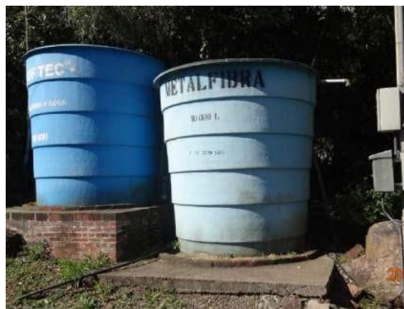
Figura 58: Reservatório da Linha Herval.
