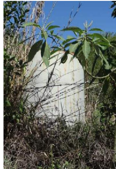
Figura 49 – Reservatório - Linha Castro Alves
