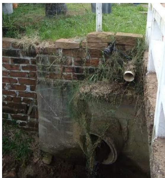
Figura 96: Canalização conectada ao arroio.
