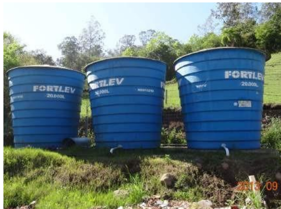
Figura 30: Reservatórios do poço Ciclério.
