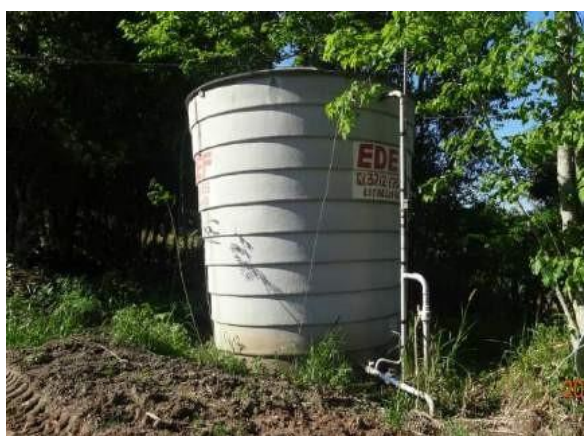
Figura 61: Reservatório da Linha Michels.
