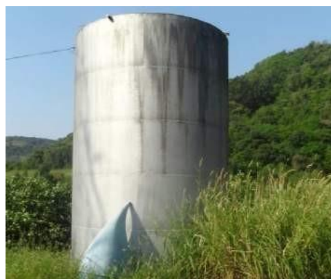
Figura 68: Reservatório da Linha Rosenthal.
